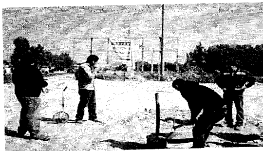
Pozo de visita No. 1
