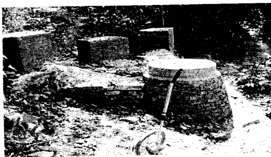
Pozo de visita y descarga sanitaria
