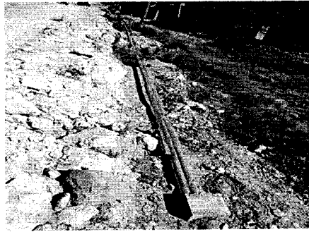
Tubería de Fo. Go. de 3"
