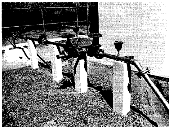
Base de equipo y Tren de descarga (equipamiento) de bombeo
