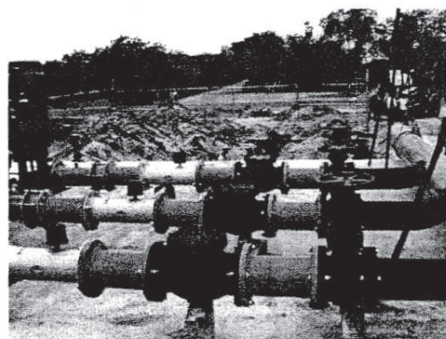
Tren de descarga en rebombeo
